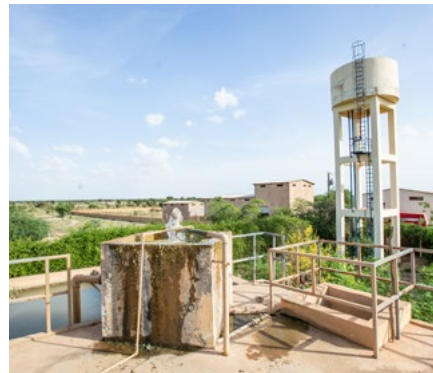
Unité de potabilisation et de traitement de Thiago
