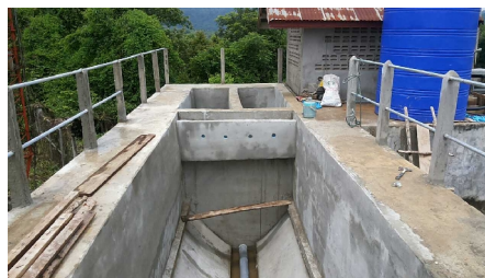
Le bassin de sédimentation lamellaire de Hinheup
